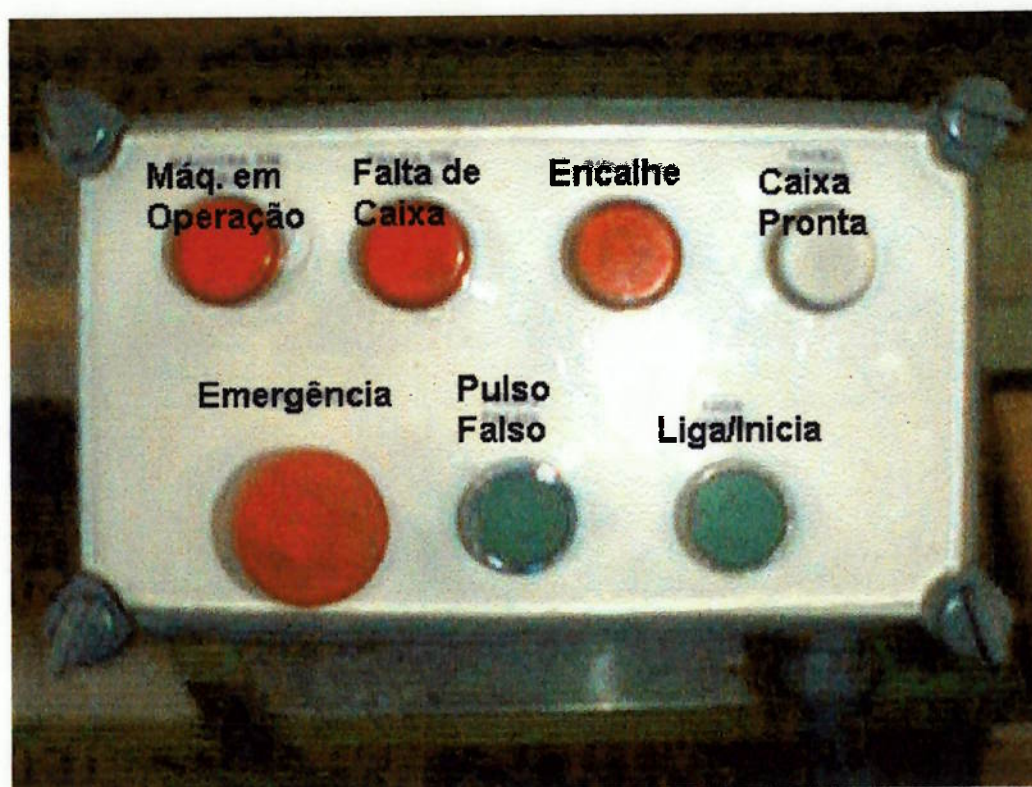
figura 5.3.2 Painel de Comando
